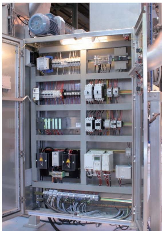
Armario eléctrico para mezclador
