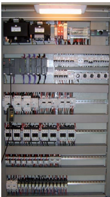
Armario eléctrico para apilador
